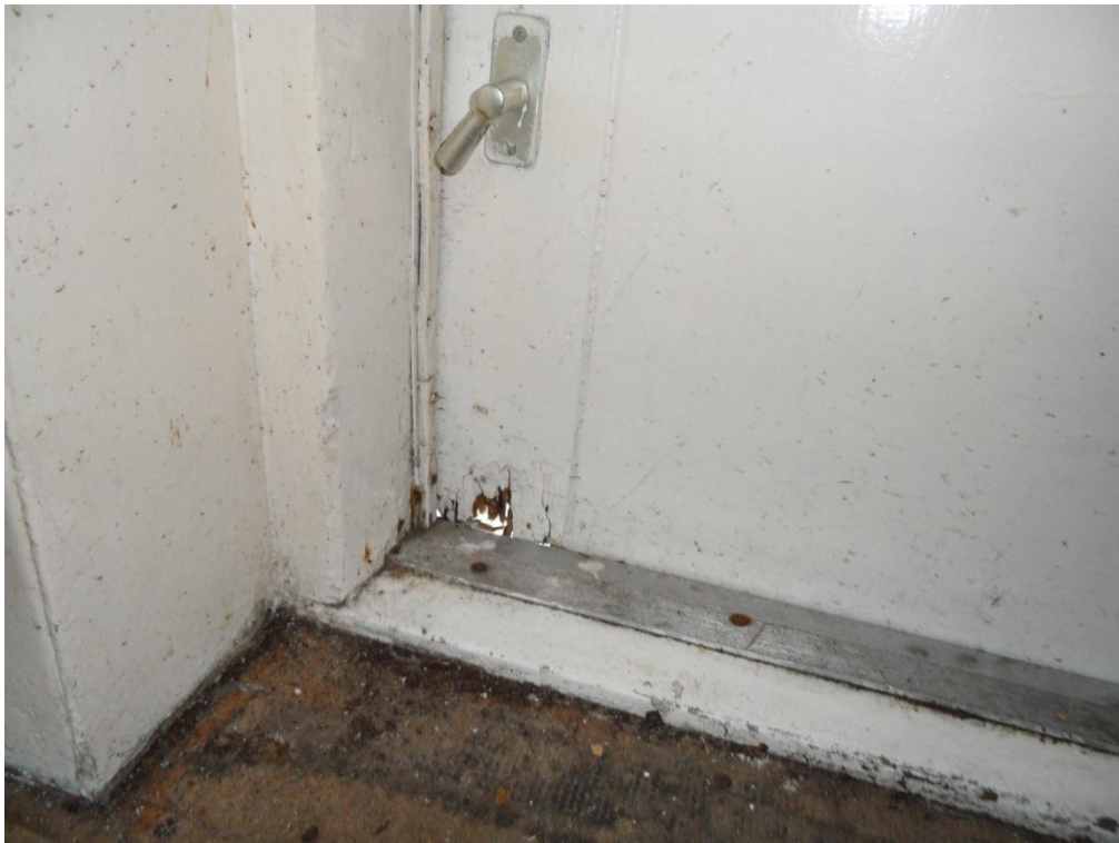
Bijlage VI, figuur 7.4: Balkondeur gezien vanuit de keuken. De deur is aan de onderzijde verrot, hierdoor is reeds een gat ontstaan. Dit moet aangepakt worden voordat er nieuwe huurders komen kijken (foto: Myles, M.).
